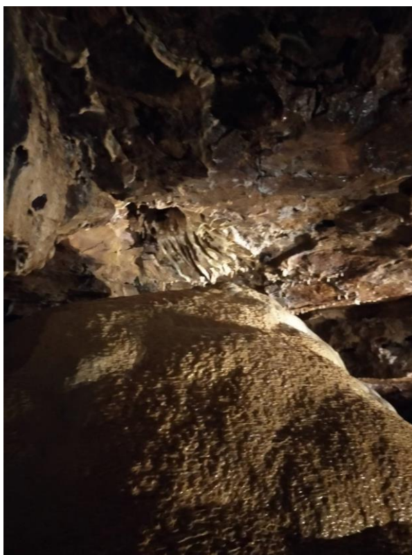
Empilement de calcite au droit d'un puits d'aération de la galerie
