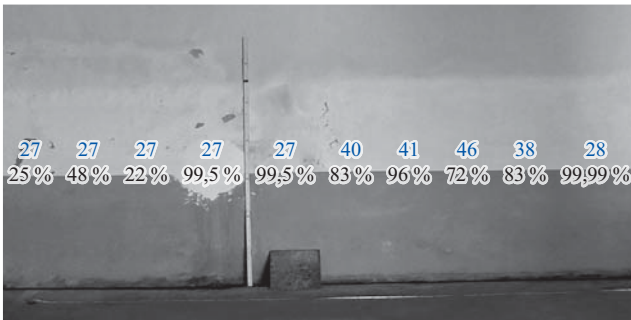
▲ Photo 18. Corrélation entre humidité et résistance mécanique dans un voile rendu concave par la pression de la nappe (source : CJR Audits).
