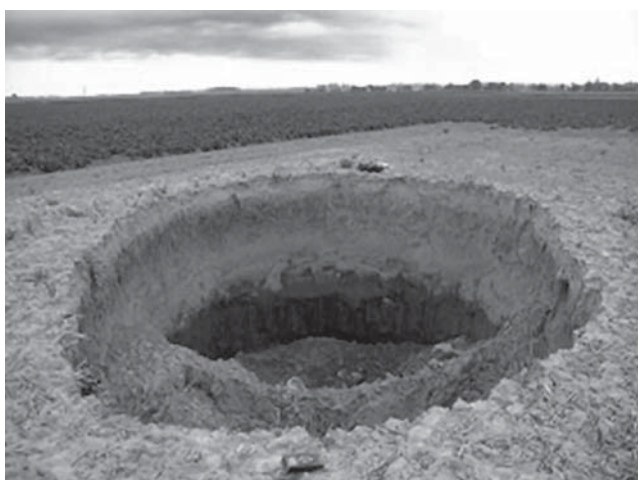
▲ Photo 5. Fontis au droit d'une carrière (source : BRGM).
